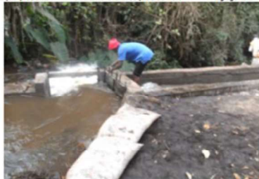
Réglage vanne alimentation eau, une infime partie ici passe dans le canal, le reste poursuivant son cours, mais avec un petit réservoir prévu en cas de baisse niveau
